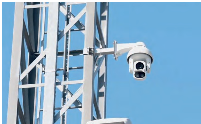
Kamera v kupoli, nameščena na enega od nosilcev voznega omrežja
