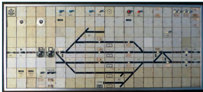
Iskrin Ljutomer je bil izločen ob modernizaciji proge Ormož – Murska Sobota oziroma ob ponovni zgraditvi proge Murska sobota–Hodoš–Madžarska leta 2001. Proga je zdaj vodena na daljavo.
