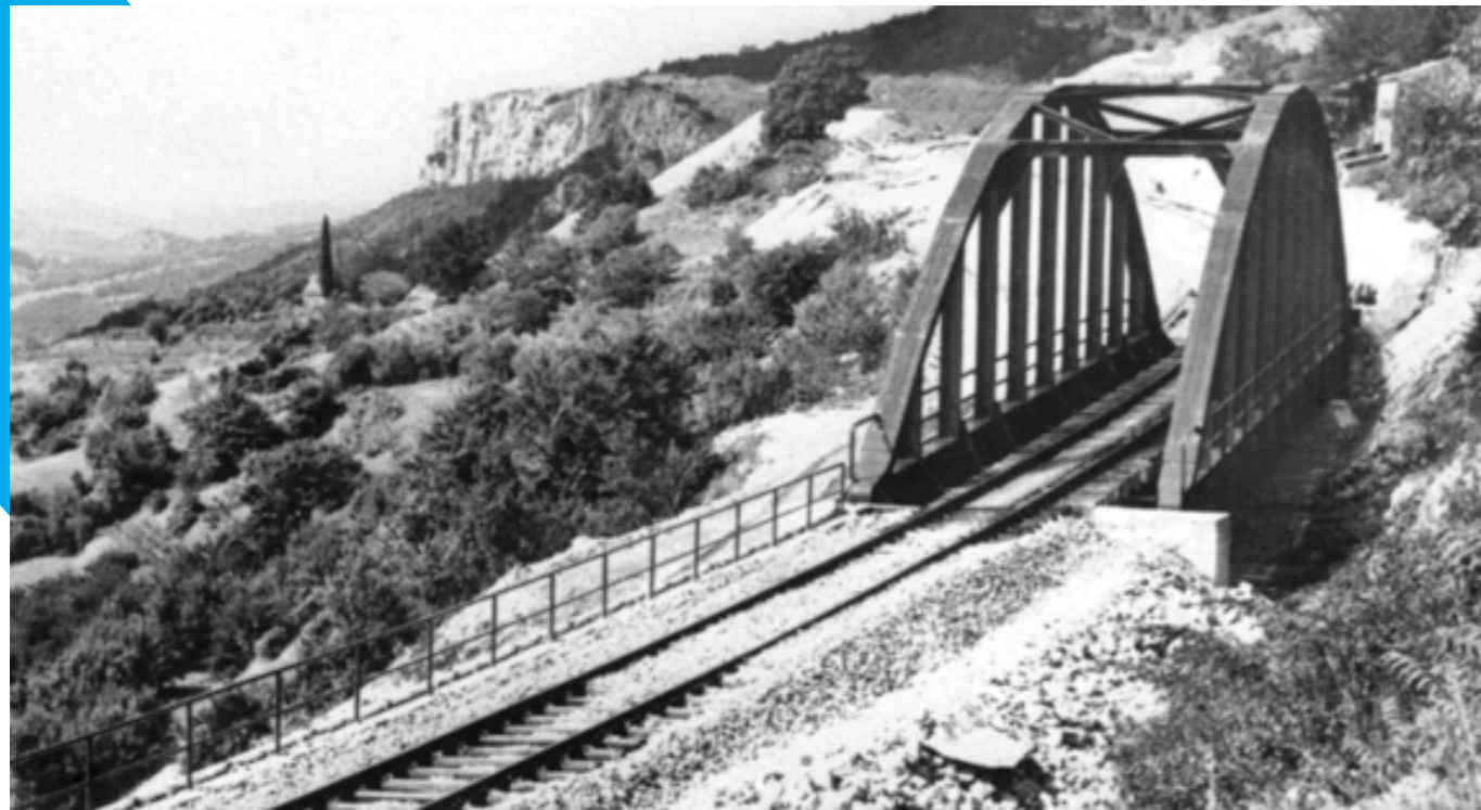
Slika 27: Most iz Gozda – Martuljka v novem življenju premošča zemeljski plaz pri vasi Podpeč. Foto: Pleterski
