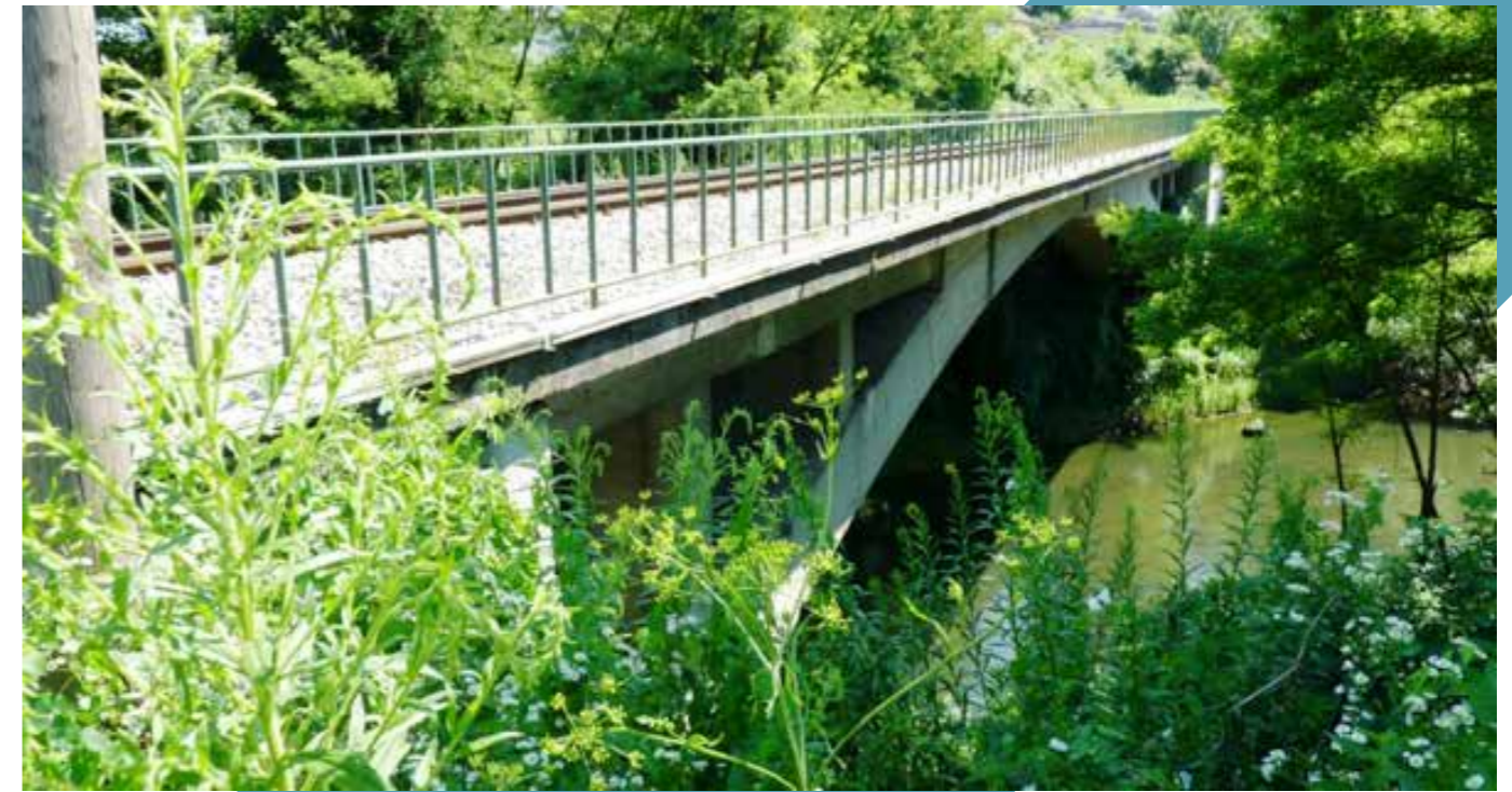
Slika 44: Nov armiranobetonski ločni most čez Gruberjev prekop je dolg 60 metrov. Foto: Mladen Bogič
