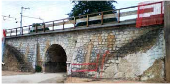
Slika 46: Stari cestni prepust v Zeleni jami so za kratek čas popolnoma razgalili, da je bila vidna lepa kamnita struktura njegovih opornikov ... Foto: Mladen Bogič
