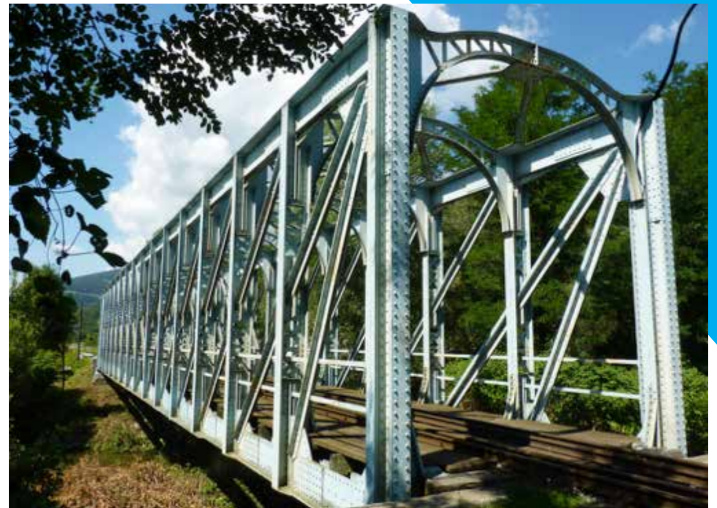
Slika 29: Most čez Mislinjo pri postaji Otiški Vrh je dolg 41,5 m in s svojimi finimi elementi in okrasjem iz kovic spominja na kovinske čipke. Prav takšni mostovi so bili zgrajeni tudi na progi Jesenice–Planica–Trbiž. Foto: Mladen Bogič
