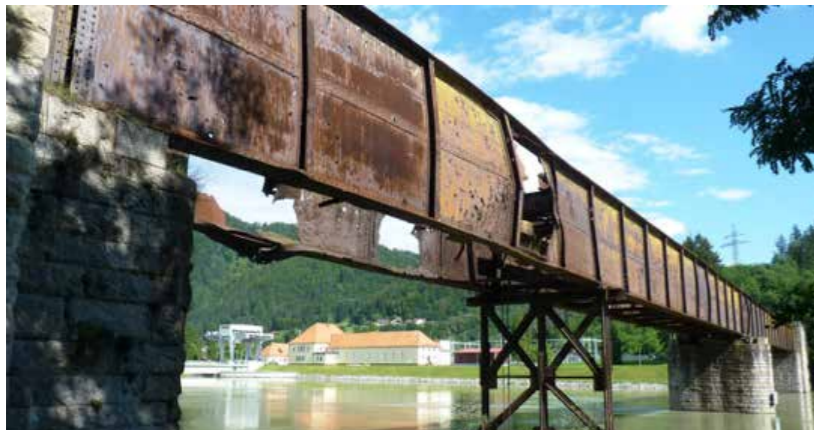
Slika 49: Opuščen polnostenski jekleni most čez akumulacijsko jezero hidroelektrarne v Dravogradu so zgradili Nemci med drugo svetovno vojno, potem ko je prvotni, 83 m dolgi kovičeni predalčni most leta 1941 minirala jugoslovanska vojska. Oba obrežna opornika sta izvedena kot dostopna viadukta in sta tako kot sredinski opornik zelo lepo izdelana v kamnu. Foto: Mladen Bogič
