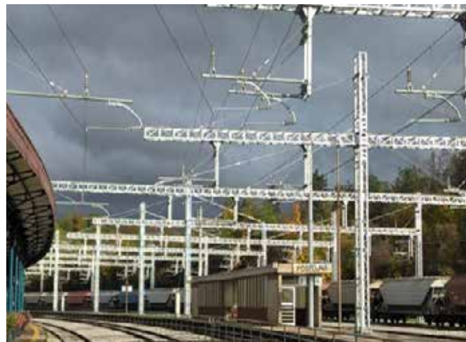
Postojna – stanje po sanaciji
