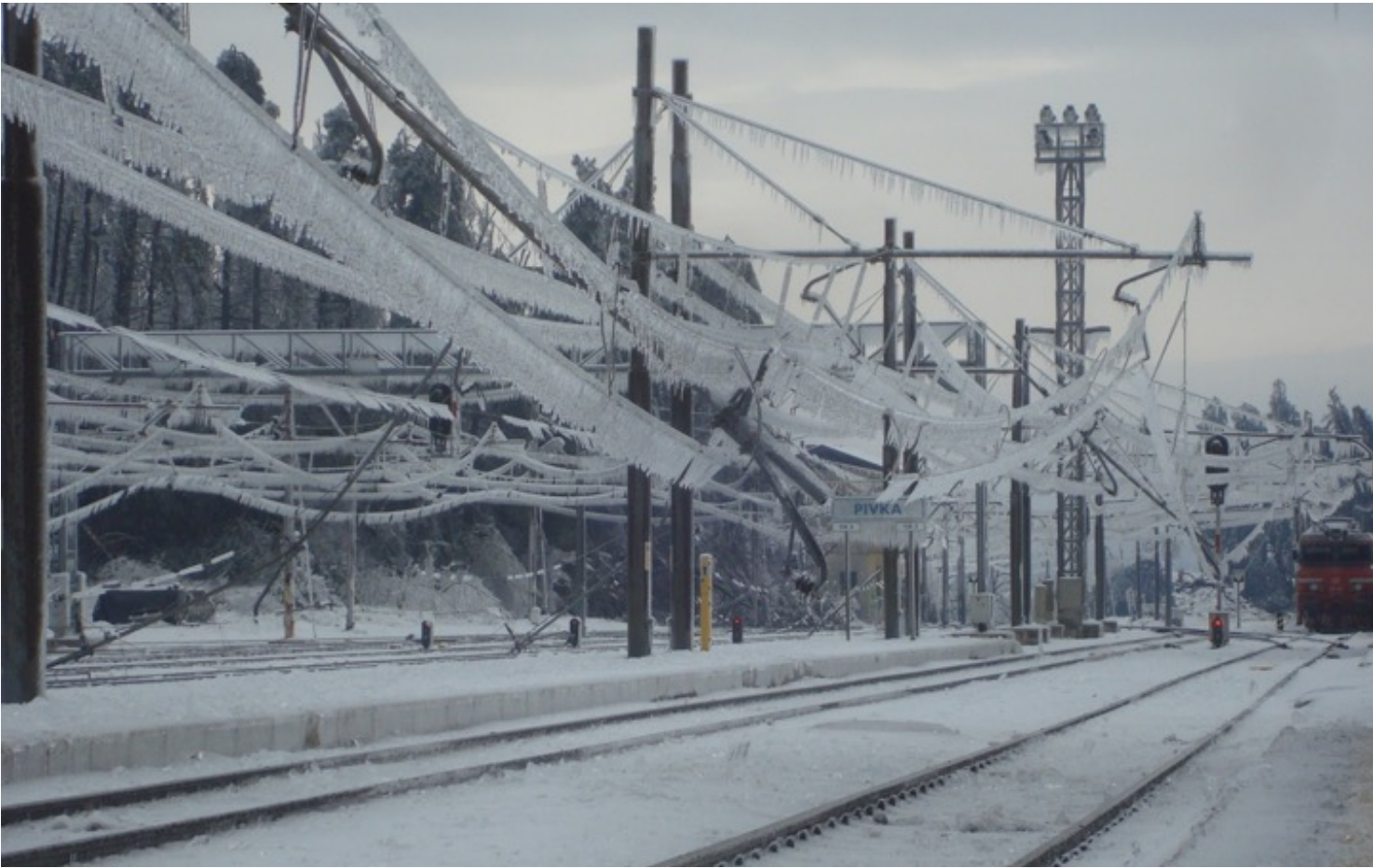
Žledna katastrofa v Sloveniji 30. 1.–11. 2. je hudo poškodovala vozno omrežje in naprave na progi proti Sežani. Promet je bil en teden prekinjen. Potem so ga postopoma vzpostavili z dizelsko vleko. Obnova je trajala več kot eno leto. Na fotografiji vidimo z ledom okovano postajo Pivka. (arhiv avtorja)
